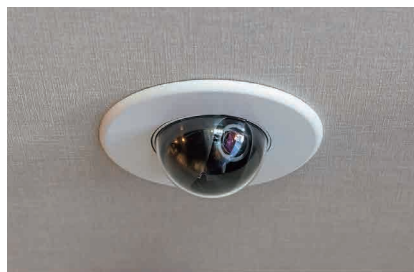
建物入口部分に録画機能を搭載した 防犯カメラ を配置。
