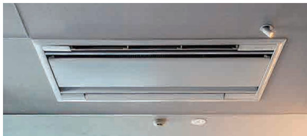
エントランスホールに エアコン を設置しています。
