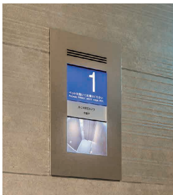
1Fエレベーターホールに カゴ内モニター を設置。乗降時の安全性を高めます。
