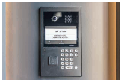
共用部2か所の オートロック で 建物のセキュリティを高めます
