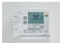
ガス温水式床暖房
